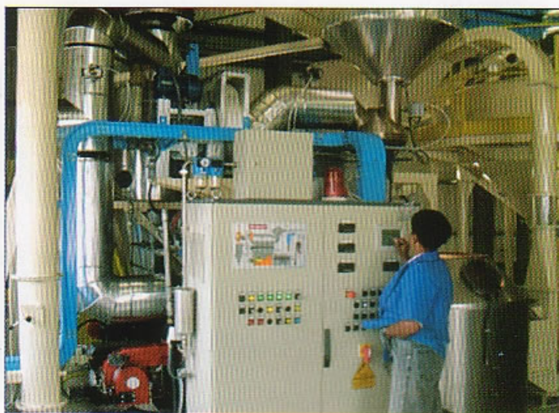
Toutes les transformations effectuées à La Tivolienne ont considérablement amélioré les conditions de travail.
